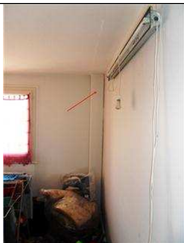
032 - Appartements - Chambre LOT 0102 PH30 : amiante ciment
