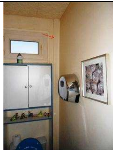
009 - Appartements - Toilette LOT 0202 PH24 : amiante ciment
